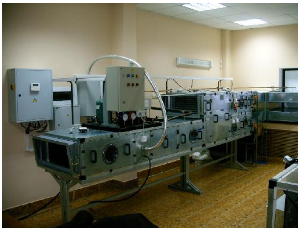
Стенд “Центральный промышленный кондиционер” лаборатории “Кондиционирование воздуха и холодоснабжение”
