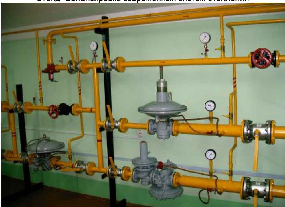
Стенд "Газорегуляторная установка" лаборатории "Газоснабжение"
