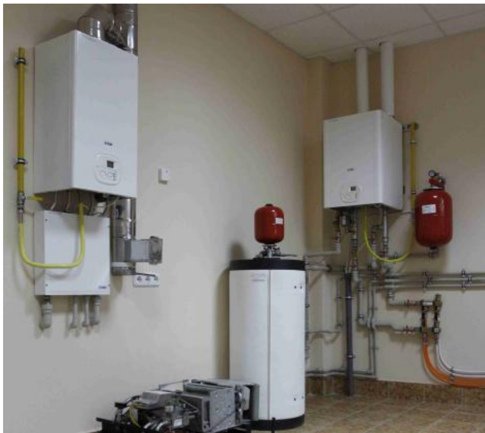
Стенд лаборатории “Теплоснабжение” с газовыми котлами
