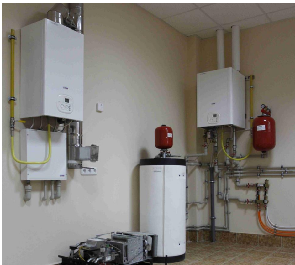
Стенд лаборатории “Теплоснабжение” с газовыми котлами
