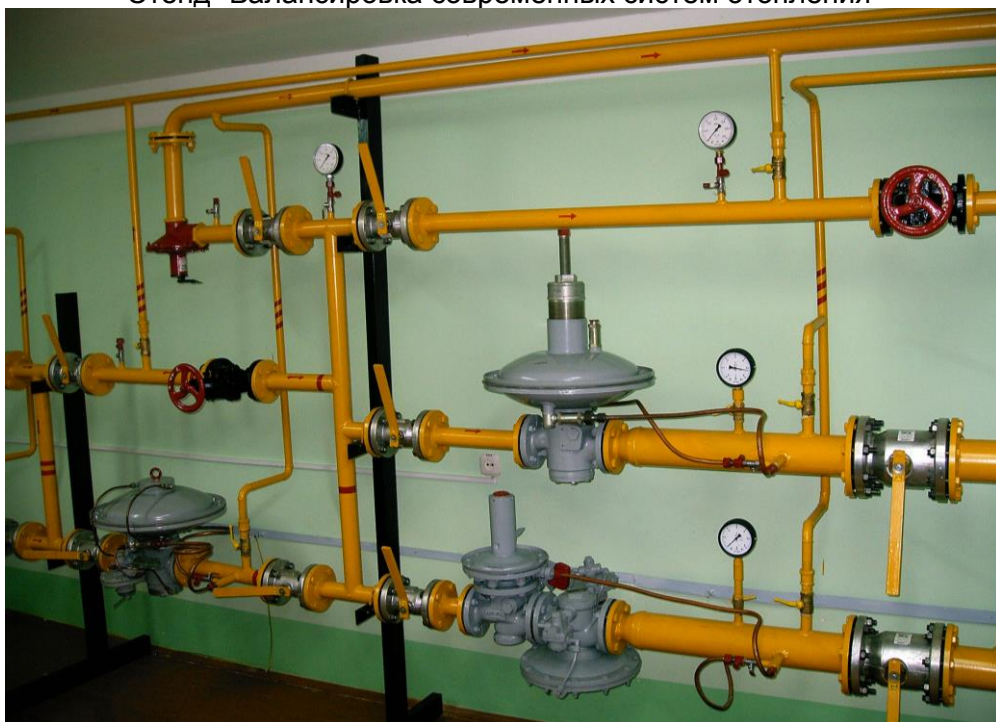
Стенд "Газорегуляторная установка" лаборатории "Газоснабжение"
