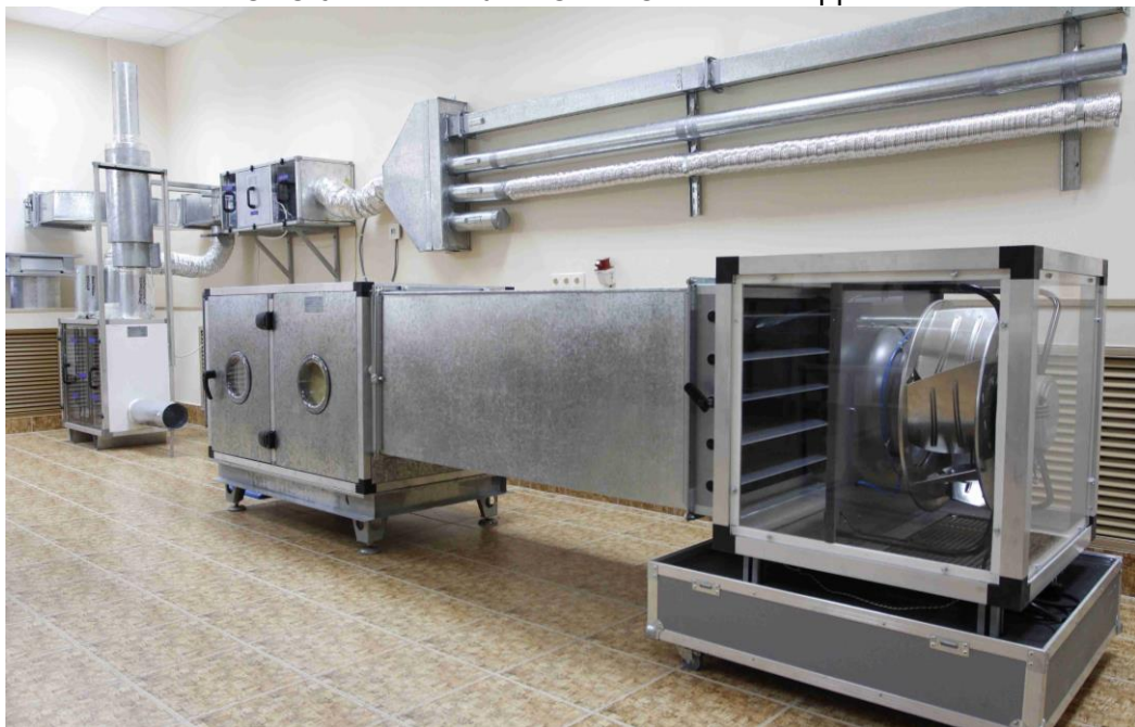
Часть стендов лаборатории “Вентиляция”
