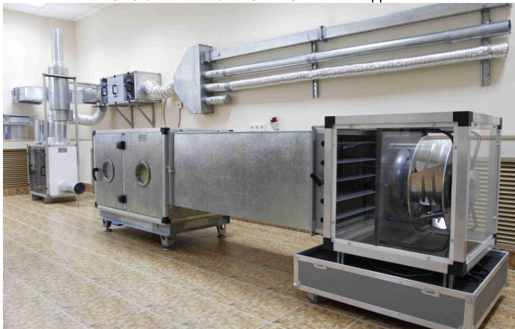
Часть стендов лаборатории “Вентиляция”
