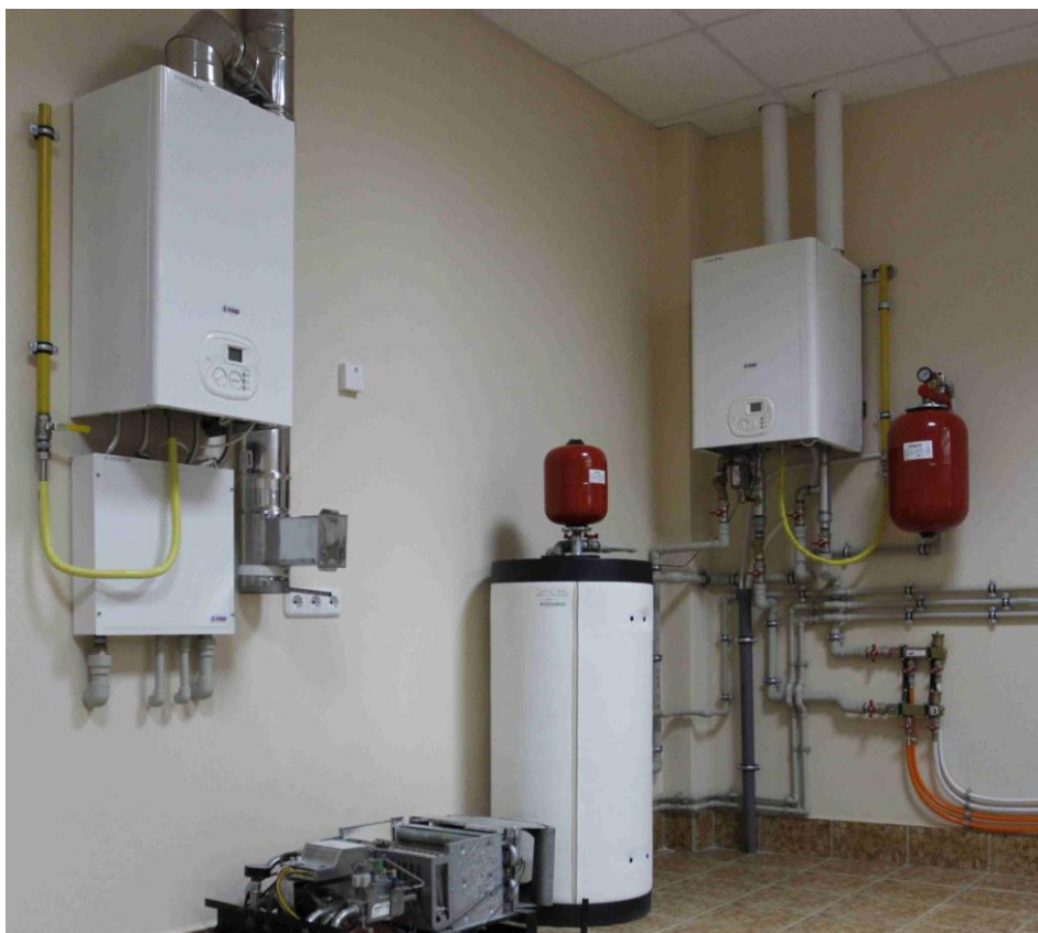
Стенд лаборатории "Теплоснабжение" с газовыми котлами
