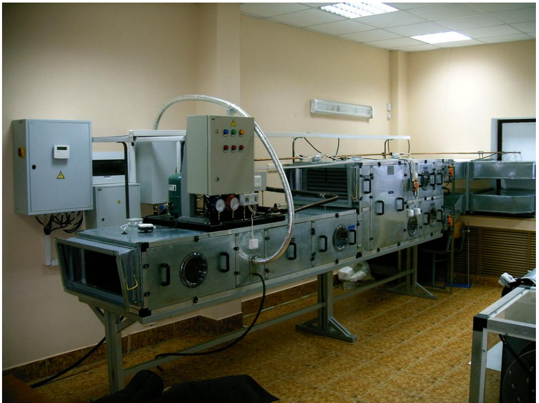
Стенд “Центральный промышленный кондиционер” лаборатории “Кондиционирование воздуха и холодоснабжение”
