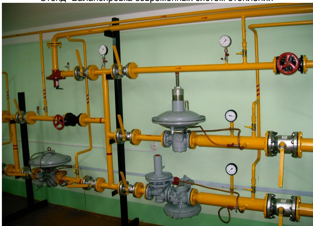
Стенд "Газорегуляторная установка" лаборатории "Газоснабжение"
